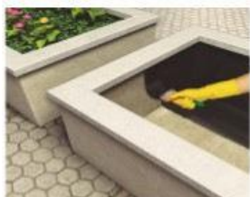
Para impermeabilizar jardineras por el lado interior que estará en contacto con la tierra.
